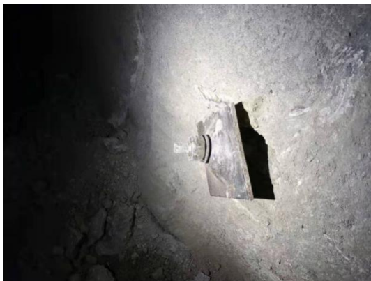
图 2-4 锚杆的托板未紧贴岩壁
