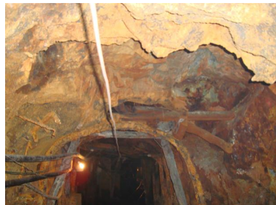
图 2-5 巷道支护材料锈蚀
