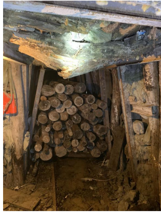
图 2-2 未及时修复受破坏的支护
