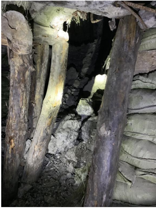
图 2-1 采场使用腐朽劈裂的坑木支护
